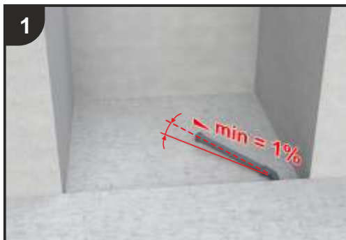
1 Posa della tubazione di scarico con pendenza minima 1% Laying the drain pipe with a minimum slope of 1%
