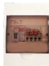
Quadro di controllo
